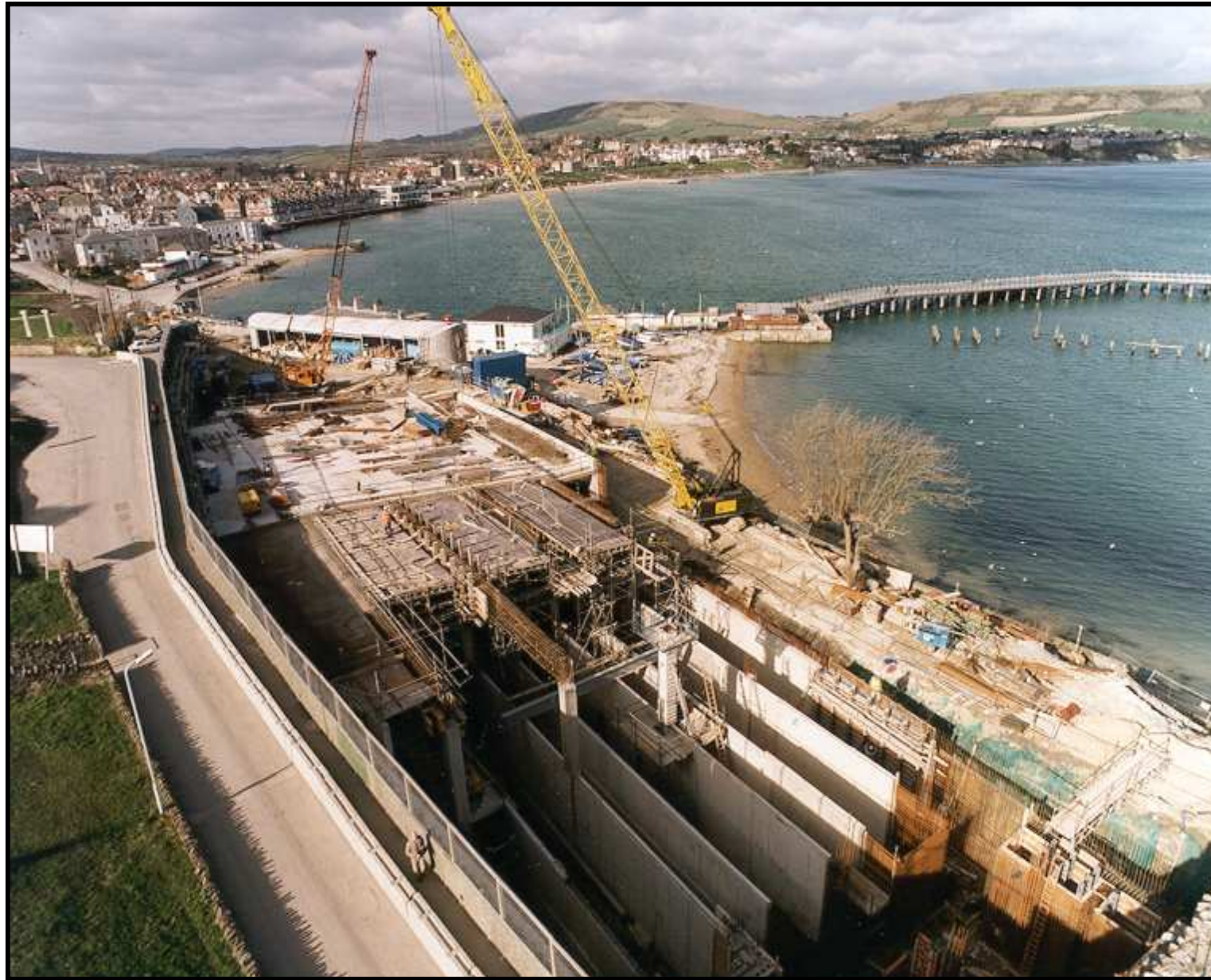
Impianto MBR di Swanage, UK
