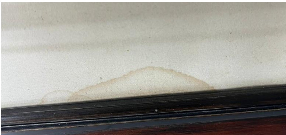
Dettaglio gora lungo il margine inferiore
