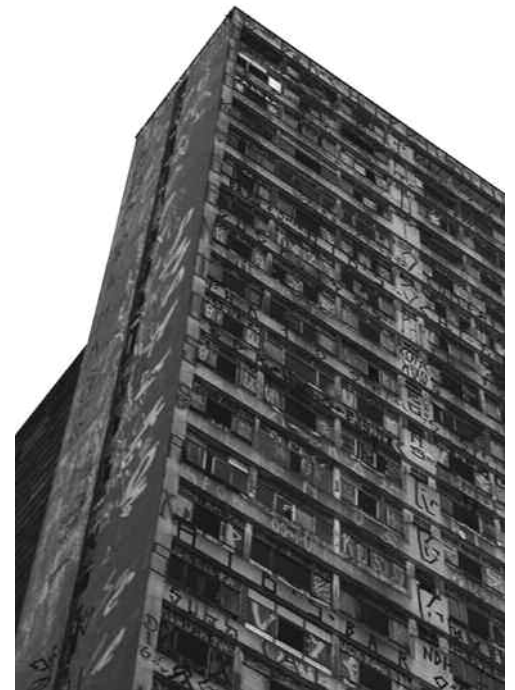
Uno degli edifici nel centro di São Paulo, in forte stato di degrado, oggetto del programma di riqualificazione.
